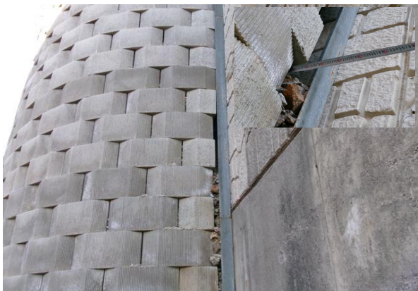
주변영향인자 S18 옹벽 내부 충전물 유실(22년)
