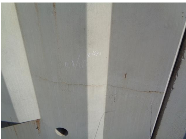
전면부 S3 균열(Cw=0.3mm미만)
