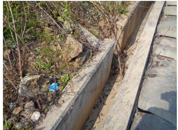
주변영향인자 S2 균열( C_w=0.3\text{mm} 이상)
