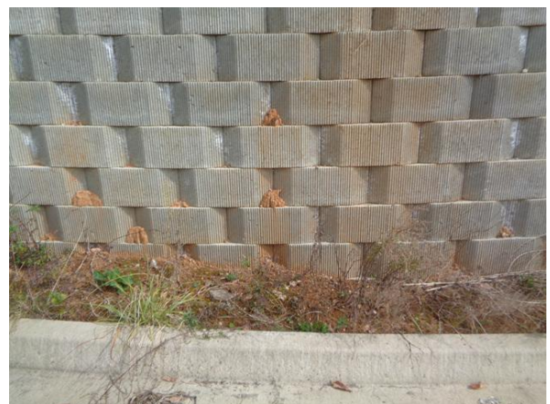
전면부 S5 블록 균열
