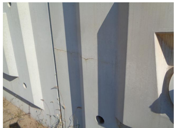
전면부 S3 균열(Cw=0.3mm미만)
